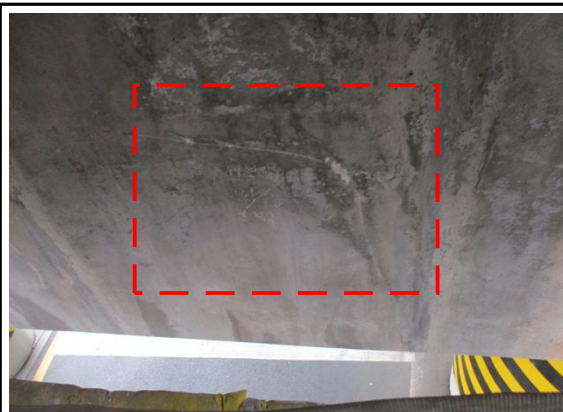
균열 및 백태 (P24)
