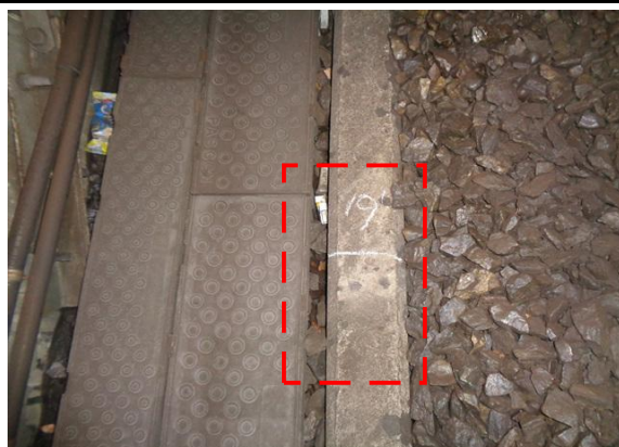
자갈막이 균열(폭 0.3mm미만) (S29-외선)
