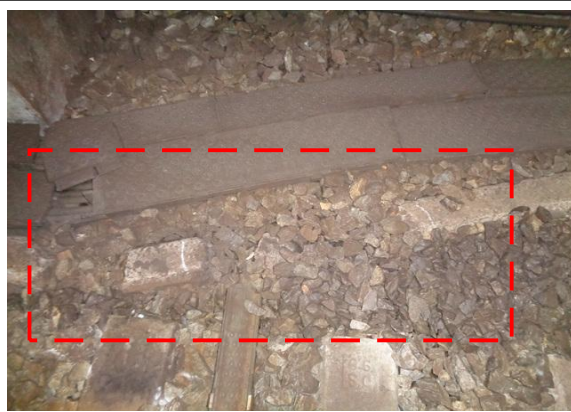
자갈막이 콘크리트 파손 (S25-외선)
